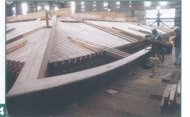
14 軒廻り組立／復原根拠として重要な旧興隆寺材の木負・茅負や垂木、化粧裏板材は、補修し再利用した。
