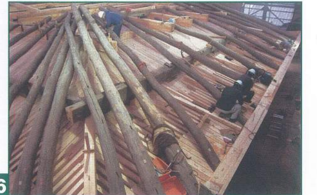
16 桔木組立／深い軒先を支えるための桔木材は、移築時の明治材を再利用して取り付けた。
